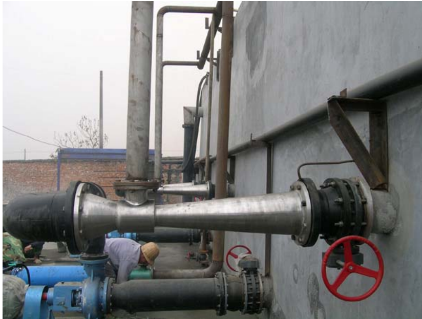
GW射流器工程安装现场（蔗糖酒精废水）
